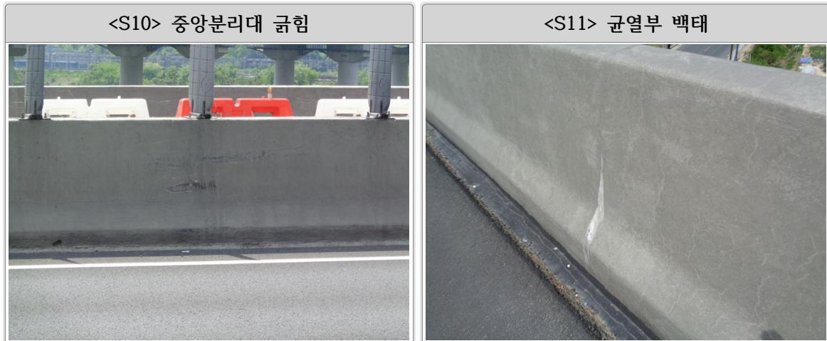
<표 3.2.2> 방호벽 및 중앙분리대 손상물량표
