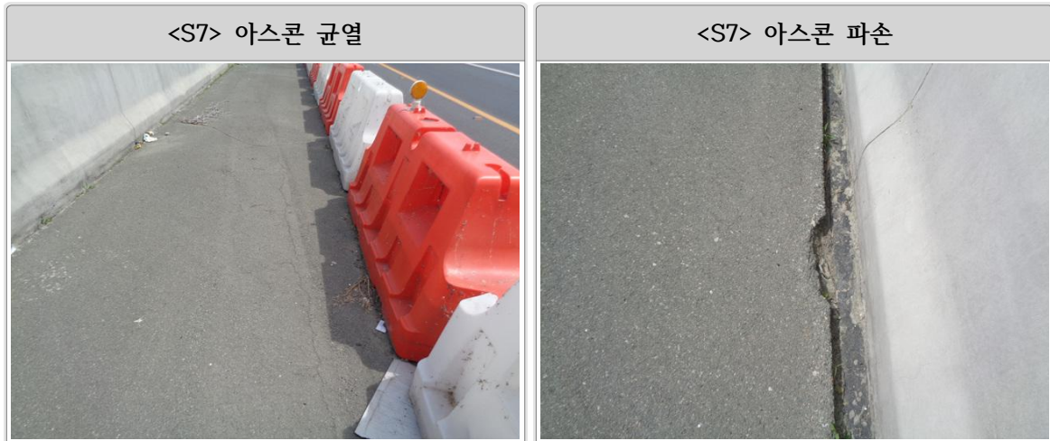
<표 3.2.1> 교면포장 손상물량표
