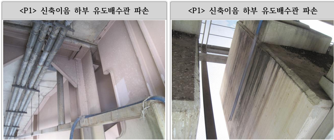
<표 3.2.3> 배수시설 손상물량표
