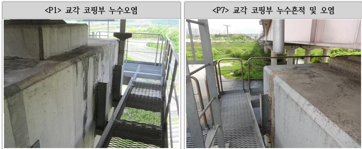
<표 3.2.14> 교대 및 교각 손상물량표
