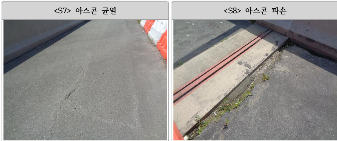
<표 3.3.1> 교면포장 손상물량표
