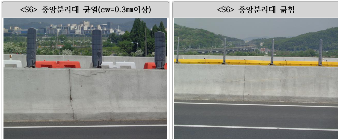
<표 3.3.2> 방호벽 및 중앙분리대 손상물량표
