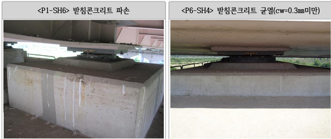
<표 3.3.10> 교량받침 손상물량표
